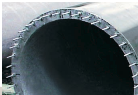
Coupe transversale d'un mât pour lignes à haute tension en Carbolith® d'une hauteur de 27 mètres.
